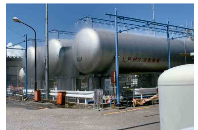
Sistema de enfriamiento con agua para tanques de LPG
