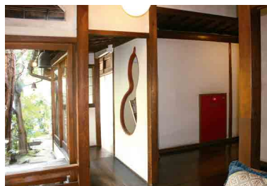
Sistema de hidrante en la posada Japonesa Matsumoto-kan
